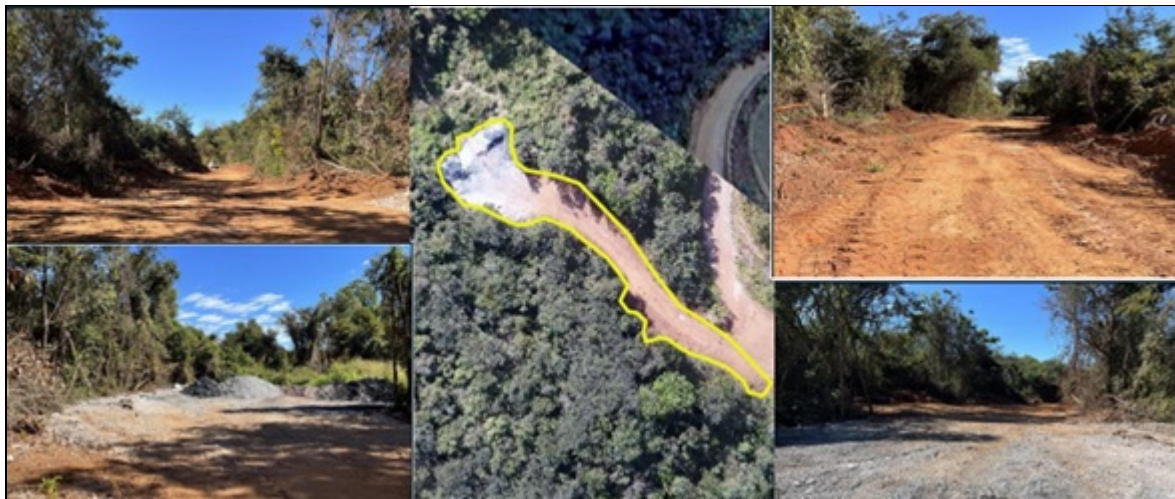
Imagem 01: Imagem de satélite da área da intervenção emergencial e fotografias tiradas “in loco” após a intervenção.
