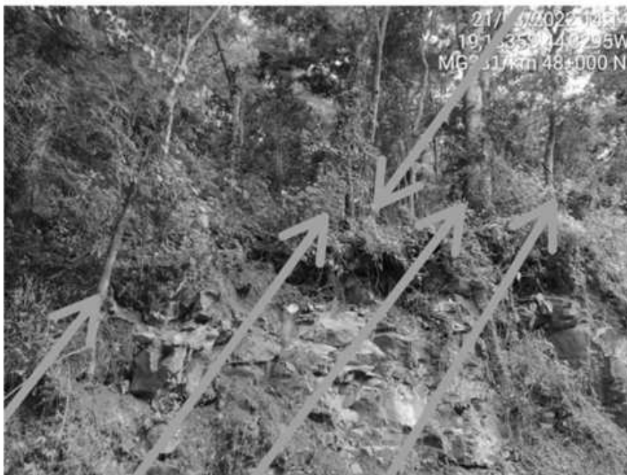
Figura 2: foto inserida no "Laudo Técnico - Supressão Emergencial Km 48 / MG231" com indicação dos indivíduos em risco de queda localizado em talude de corte na faixa de domínio da Rodovia MG 231 km 48+000, pista norte.
