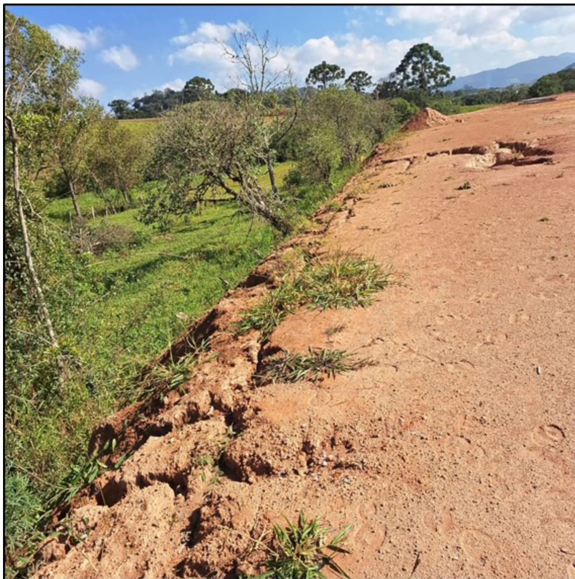
Imagem 4 - aterro sobre a app e canalização de curso d'água no empreendimento Centro Logístico Spartacus Pericos.
