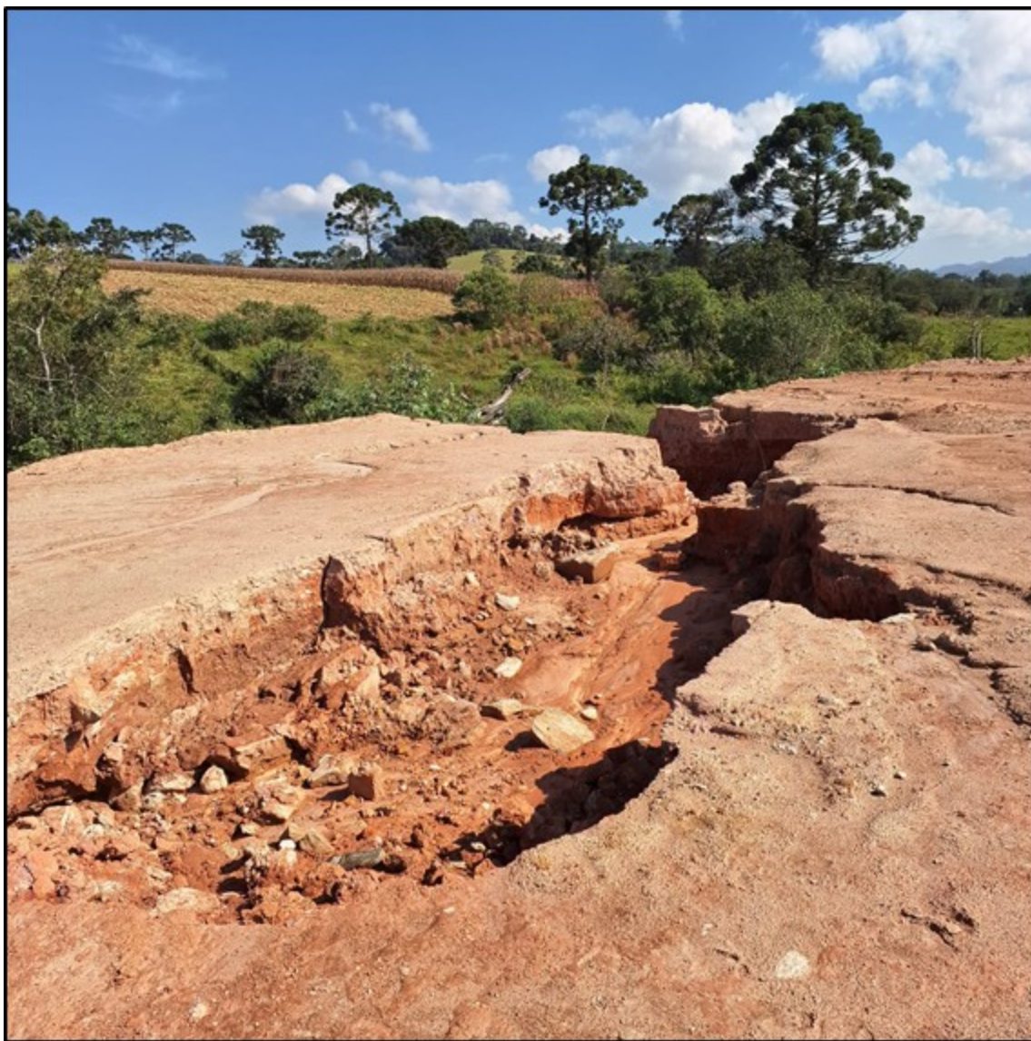
Imagem 6 - Erosão do aterro sobre canalização e a app com carreamento de partículas sólidas para o leito do córrego S/D no empreendimento Centro Logístico Spartacus Pericos.
