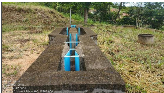
Imagem 2: Tratamento preliminar existente - 07/02/2024
