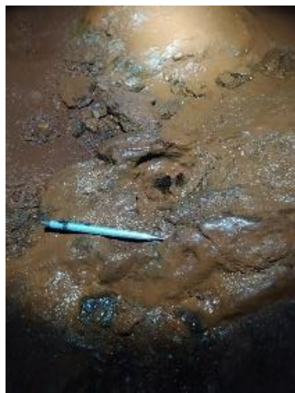
Foto 64 – Pontos de gotejamento e depósitos químicos.
