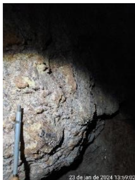
Foto 74 – Pontos de gotejamento e percolação.
