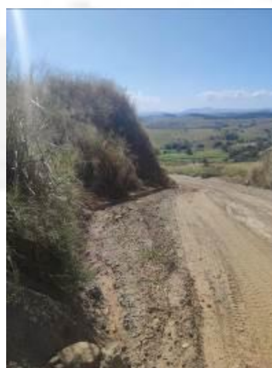
Foto 10: Sistema de drenagem
