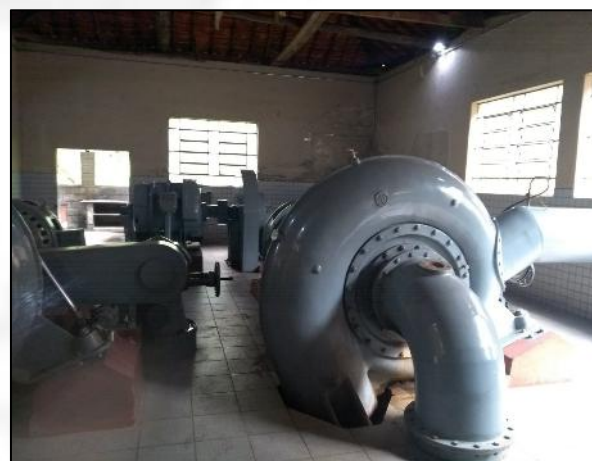
Foto 8: CGH Santo Antônio do Rio do Freire – interior da Casa de Força
