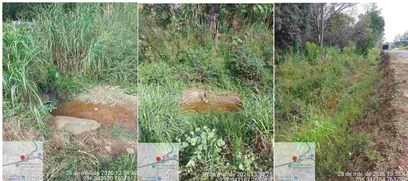
Figura 2. Área 1. Sulco ao longo do acostamento da BR-146 em área consolidada com bueiro tubular no final da condução.
