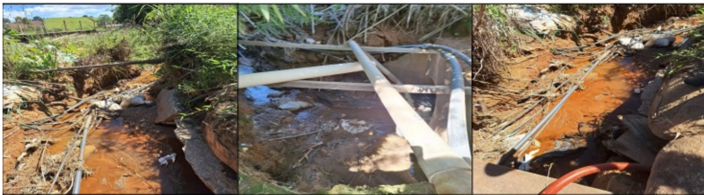
FIGURAS 02, 03 e 04 - Local de instalação da tubulação captação de água e de de emissão de efluentes industriais tratados.
