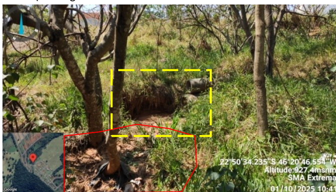
Figura 15. Saída da drenagem da Alameda Uvaia (que atenderá a Quadra O) sem estrutura de dissipação de energia e vazão e processo erosivo iniciando
