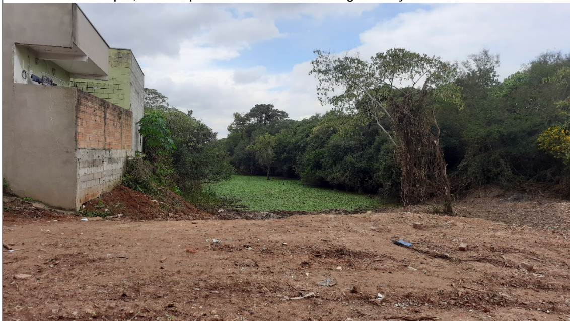
FIGURA 05: Imagem do local das intervenções ambientais em APP para instalação da estação elevatória de esgoto Yara, situado no Bairro Yara, Município de Pouso Alegre/MG.
