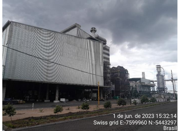
Foto 02: Sistema de despeiramento de forno.
