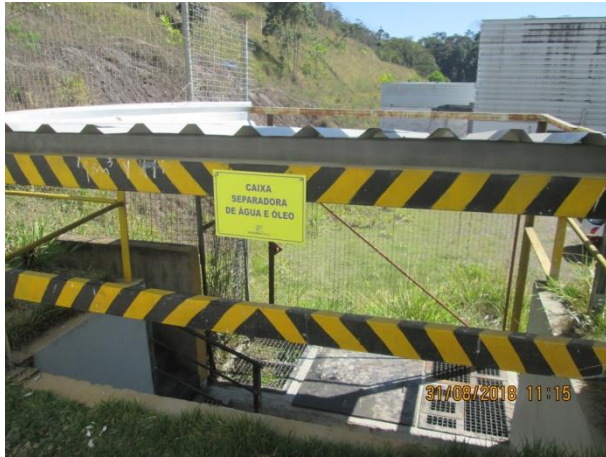
Caixa Separadora de Água e Óleo (SAO)
