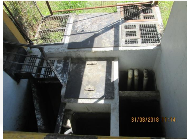
Interior da caixa SAO
