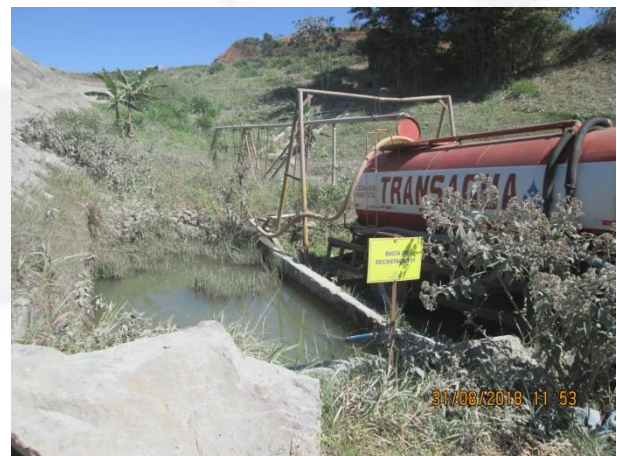
Captação de água na bacia de decantação de água pluvial
