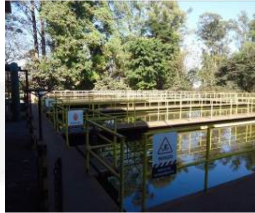
Foto 02. Estação de tratamento de água
