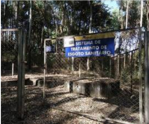
Foto 19. Tratamento efluentes sanitários
