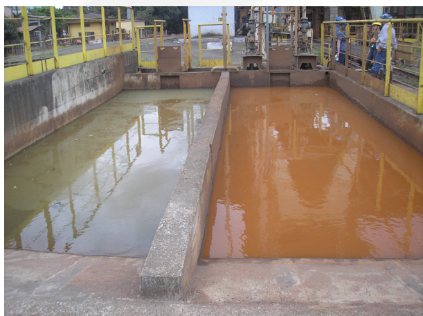
Foto 03: Bacia de Decantação.
