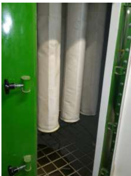
Foto 04. Filtro de Mangas.
