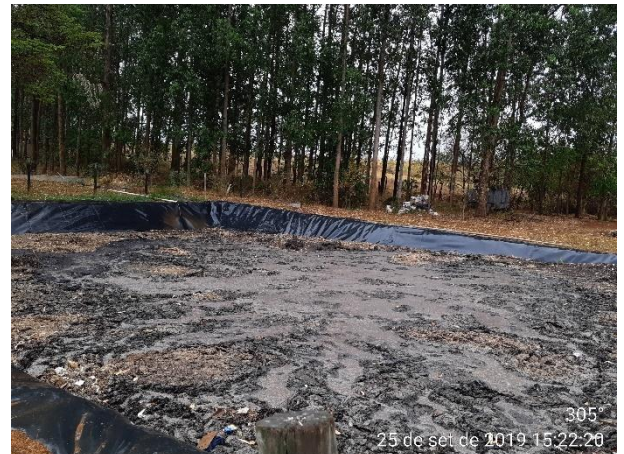
Foto 04. Tanque de equalização (ETE)
