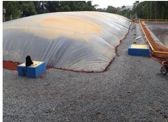
Figura 02 - Biodigestor em operação
