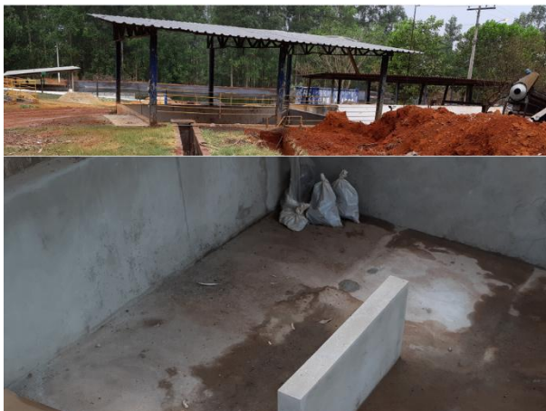
Foto 03. Tanque de bombeamento recém-construído (ETE) - fora de operação
