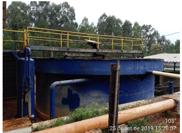
Foto 06. Tanque de flotação (ETE)
