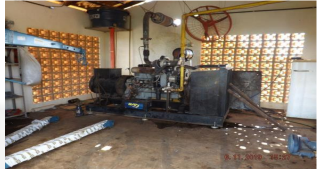
Figura 08: Gerador de energia por biogás
