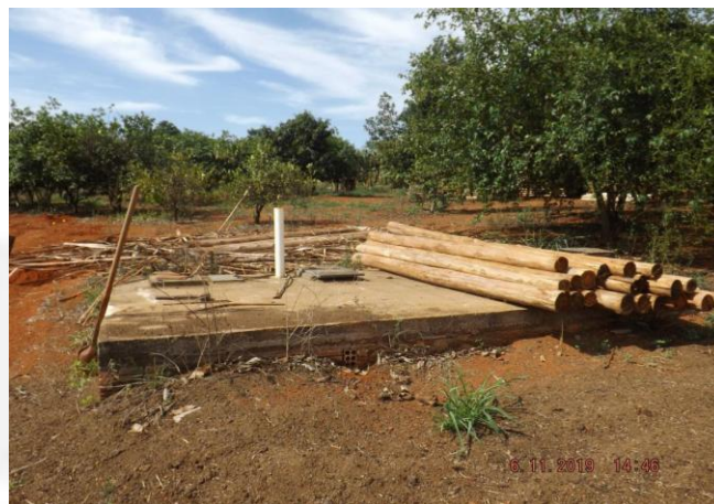
Figura 02: Fossa séptica desativada
