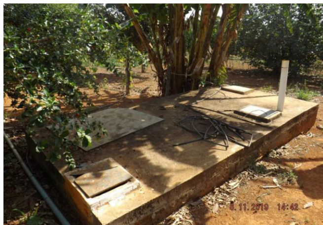
Figura 01: Fossa Séptica ativa
