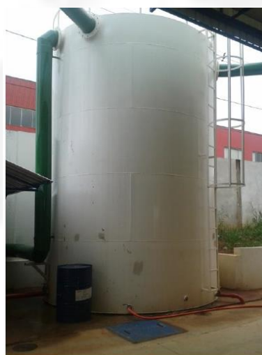
Foto 04 – Reservatório de água pluvial
