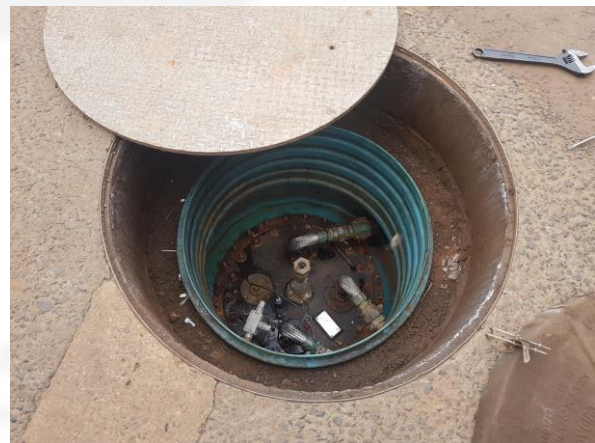
Boca de visita do tanque: sump e monitoramento intersticial
