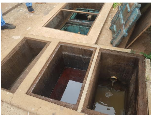
Caixa Separadora de Água e Óleo
