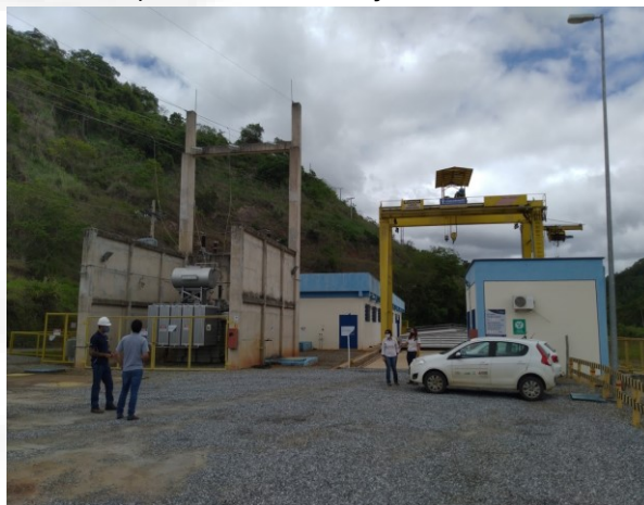
Foto 04 – Subestação e casa de força.
