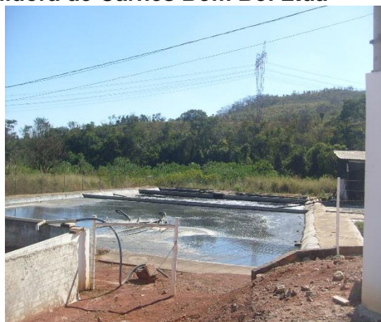
Foto 02. Visão parcial da ETEi
