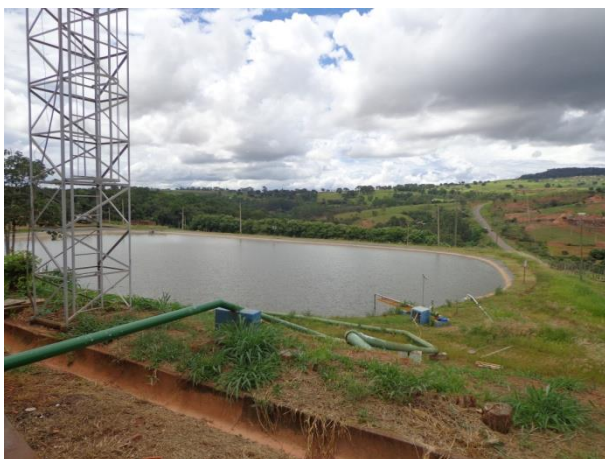
Foto 03. Lagoa de água da ETA
