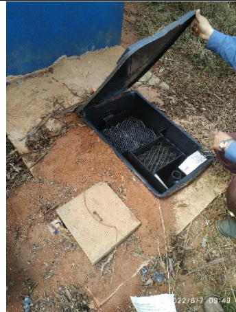
Foto 08. Caixa SAO da oficina (estanque)
