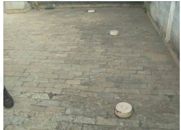
Foto 08. ETE (filtro anaeróbico e Sumidouro)
