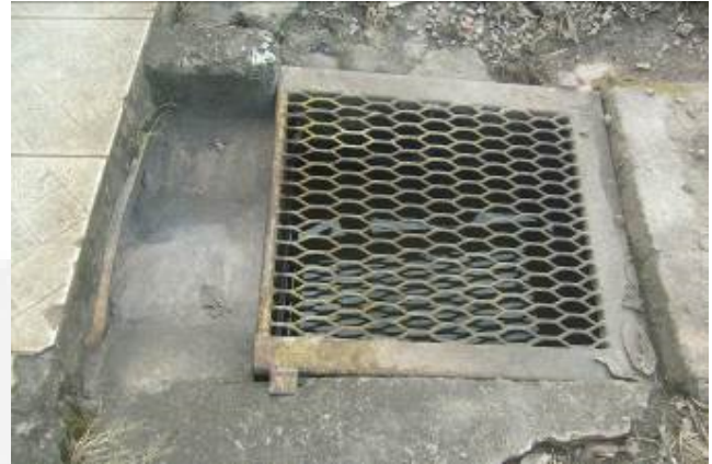
Foto 06. Caixa de Decantação
