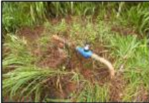
Foto 01: Hidrômetro do poço artesiano no empreendimento.
