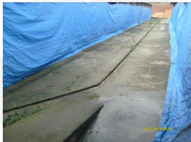
Foto 10: Sistema de drenagem pluvial
