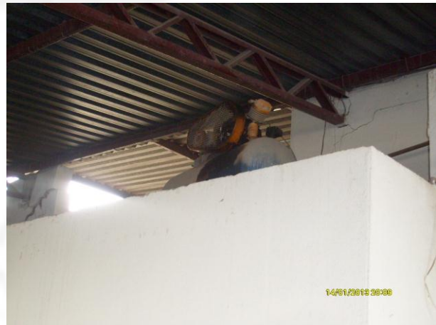
Foto 8: Compressor de ar
