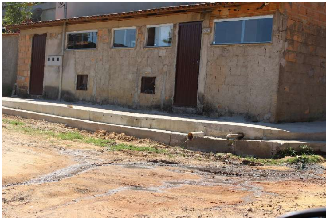
Figura 83 – Lançamento de efluente doméstico na via pública
