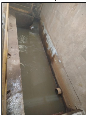
Foto 11: Sistema de drenagem de percolados
