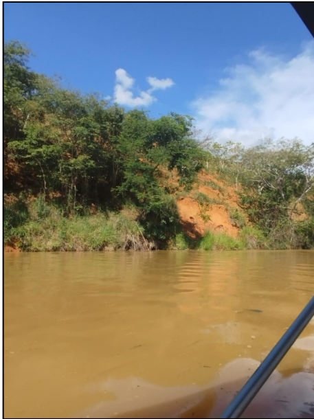
Foto 17: Processo erosivo nas margens do reservatório
