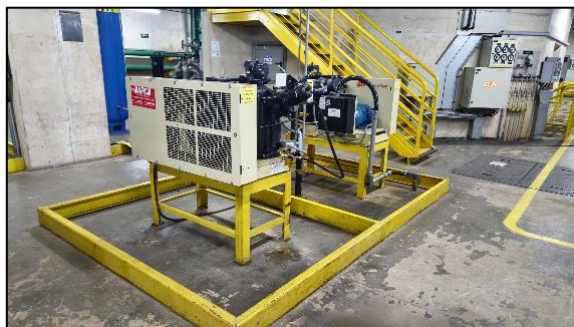
Foto 9: Barreiras de contenção de vazamentos
