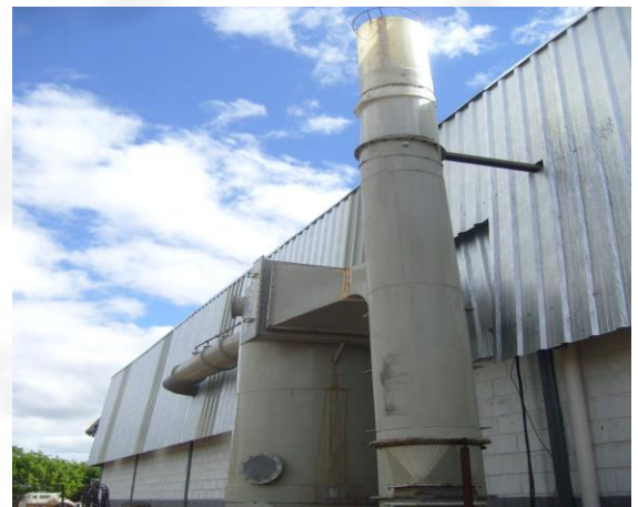
FOTO 02: LAVADOR DE GASES
