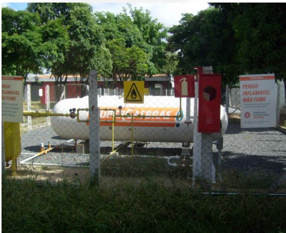
FOTO 01: TANQUE ARMAZENAMENTO GLP
