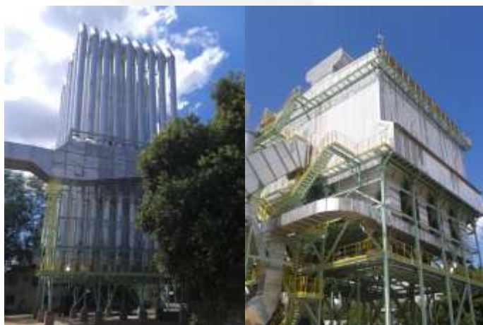
Foto 03. Sist. de Despoeiramento Forno 01
