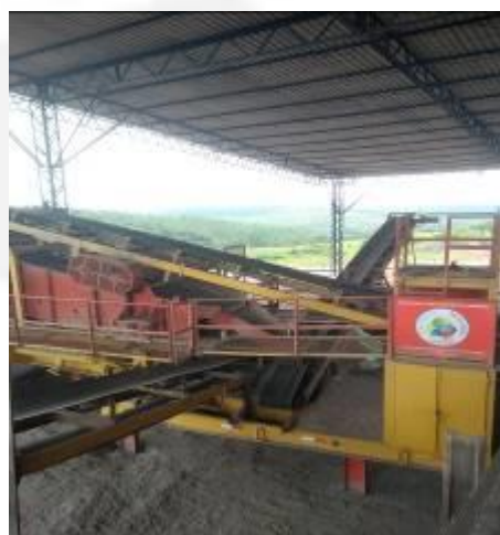
Foto 06. Planta de beneficiamento
