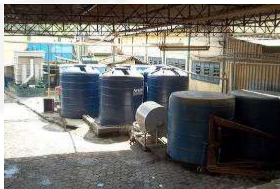
Foto 04. Visão ampla da ETE industrial.
