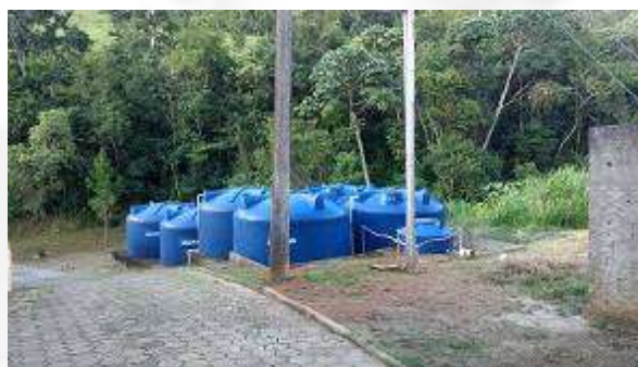
Foto 10. Tanques para armazenar água.
