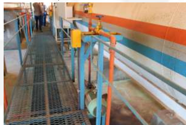
Foto 04. Tanque e dique.
