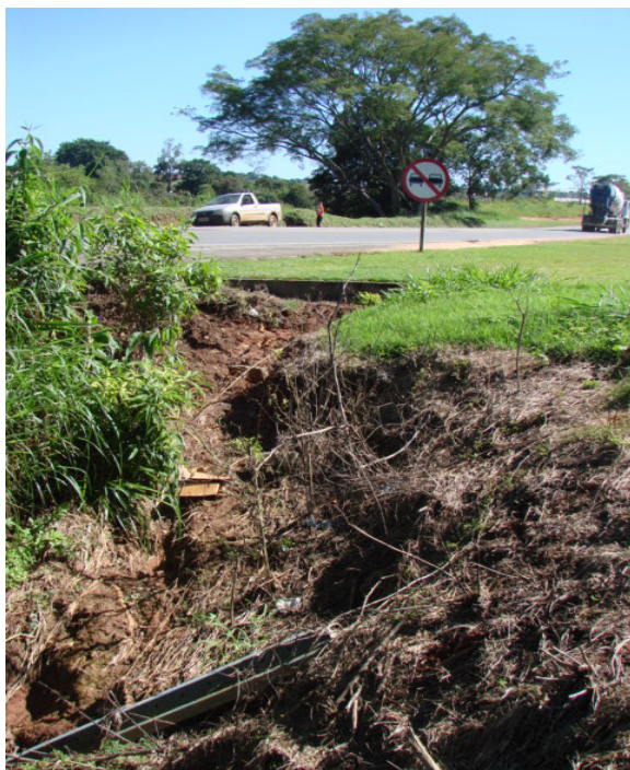
Processo erosivo às margens da rodovia MG 050
