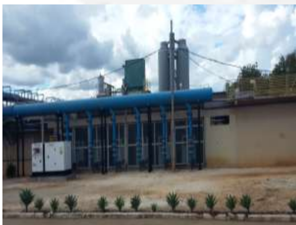
Foto 03. Sala de sopradores
