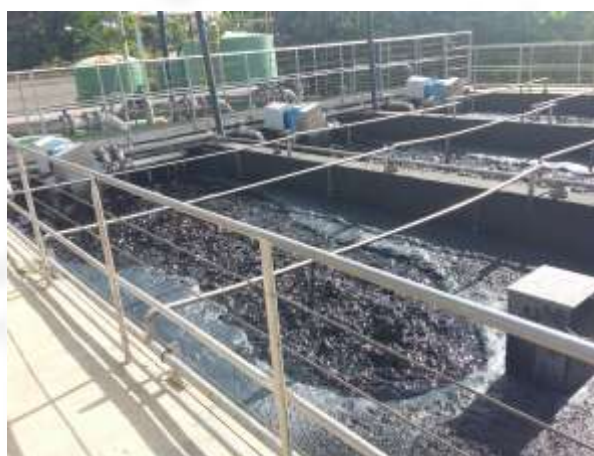
Foto 02. Tanques com módulos de membranas
