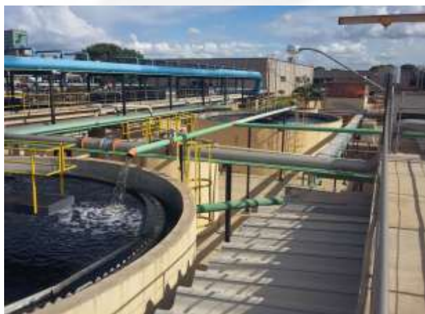
Foto 01. Vista geral da ETE
