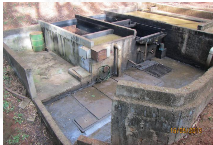
Caixa separadora de água e óleo a ser desativada
