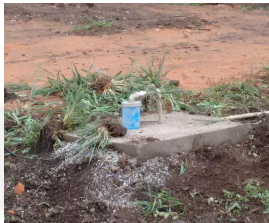
Foto 06. Poço manual (uso insignificante).
