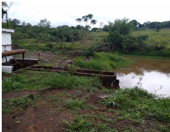
Foto 05. Ponto de captação de água superficial instalado em APP.
