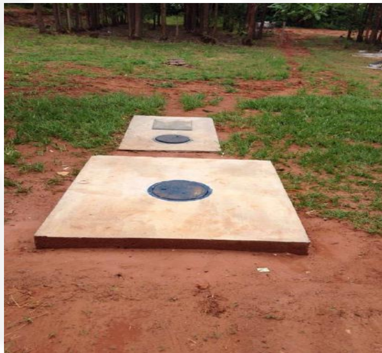
Figura 01 – Fossa séptica do empreendimento.
