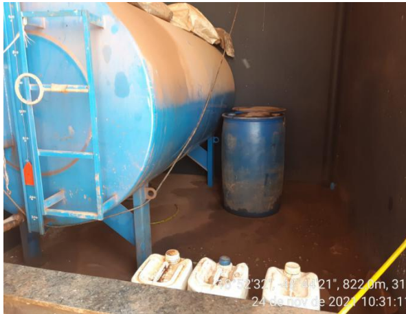
Foto 13. Tanque de combustível
