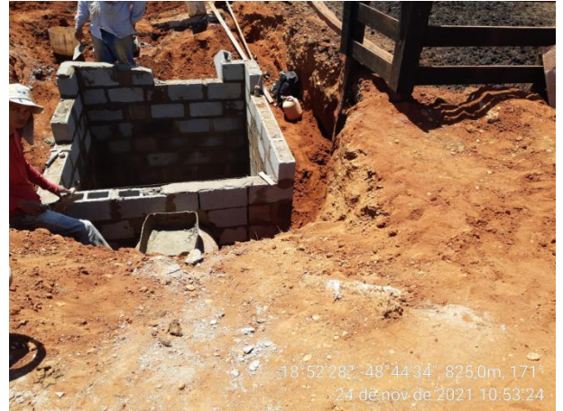
Foto 22. Tubulação de drenagem do efluente do confinamento
