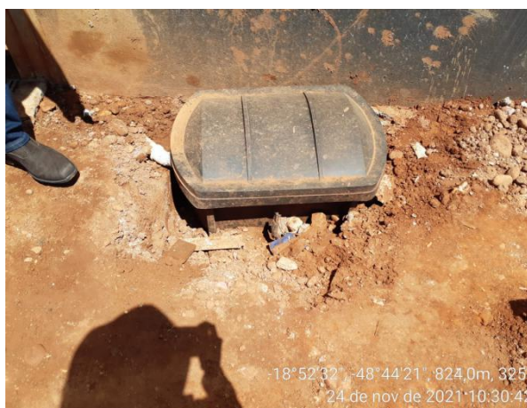
Foto 7. Caixa Separadora de água e Óleo (CSAO)
