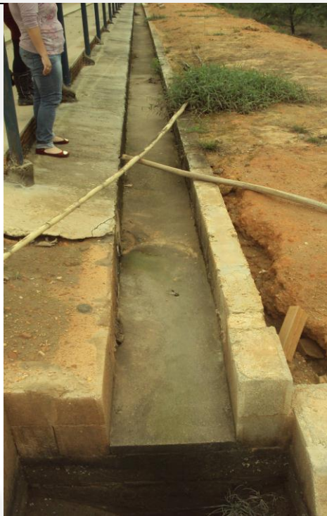
Foto 09. Sistema de drenagem pluvial.
