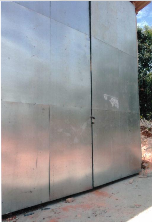
Foto 05. Depósito de pó de balão.
