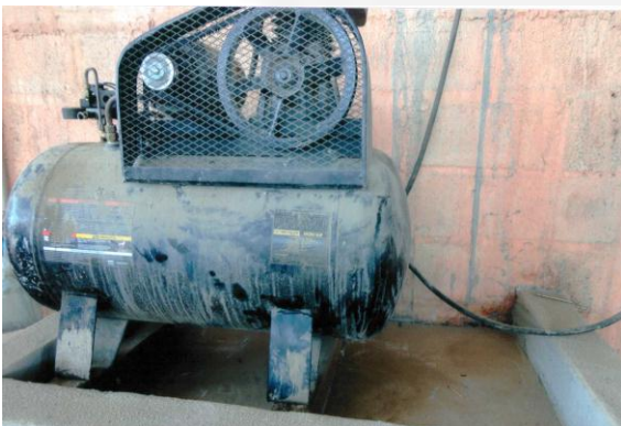
Foto 07. Compressor com bacia de contenção.
