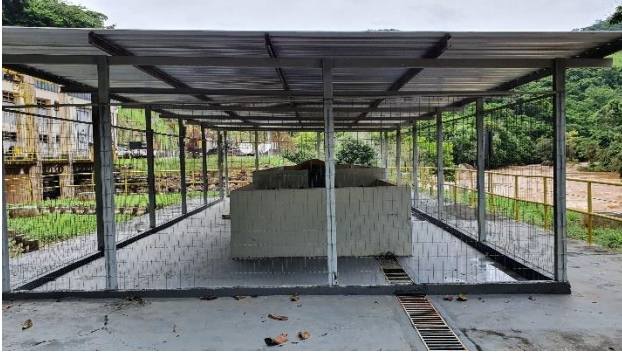
Caixa Separadora de Água e Óleo
