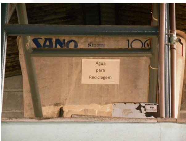
Foto 09. Reservatório para armazenagem e recirculação dos efluentes líquidos no processo.
