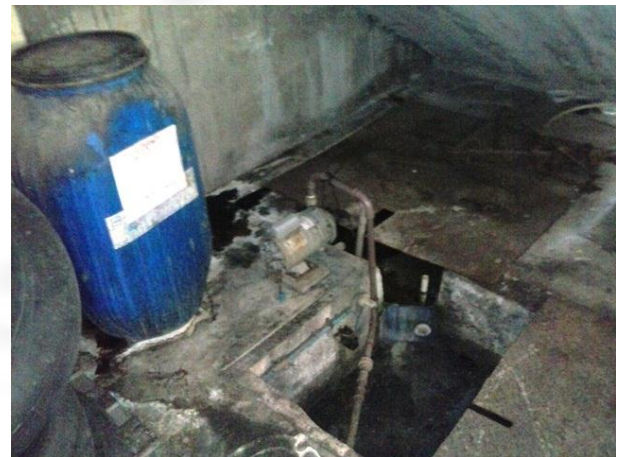
Foto 08. Área de separação do lodo e recirculação dos efluentes no processo.
