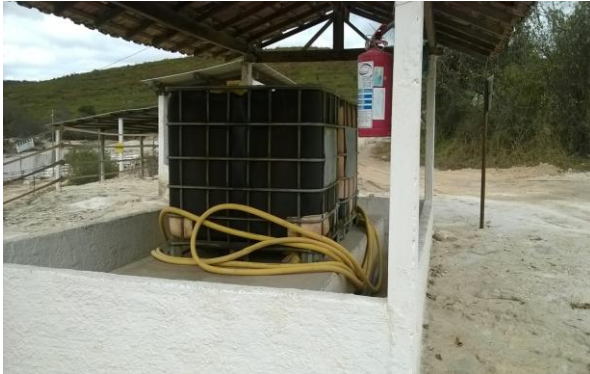
Foto 7. Tanque de abastecimento.
