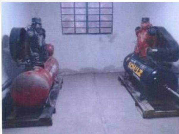
Figura 2 - Compressores de ar
