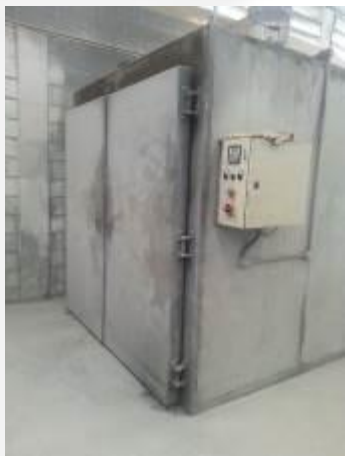
Forno de pintura eletrostática - GLP
