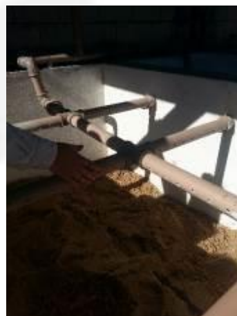
Filtro de areia – efluente tratado
