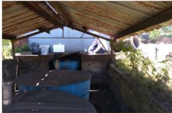
Foto 10. Fossa séptica. Fonte:RCA
