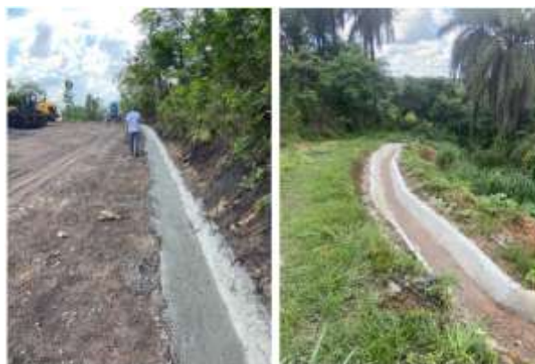
Foto 09. Sistema de drenagem. Fonte:RCA
