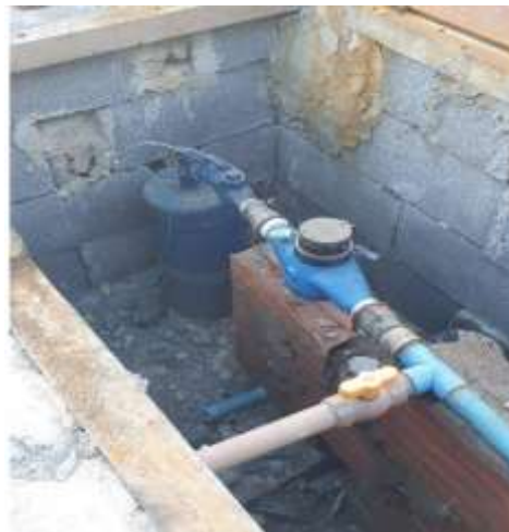
Foto 11. Poço tubular. Fonte:RCA
