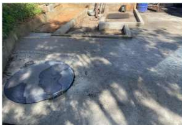
Foto 08. Caixa de contenção e CSAO – Oficina mecânica. Fonte:RCA
