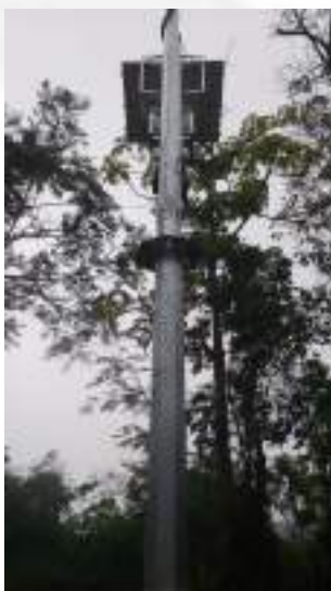
Foto 03. Sirene instalada próxima a barragem
