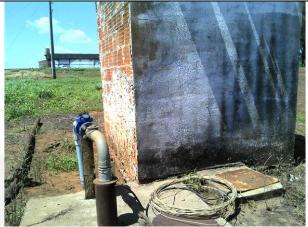
Figura 06. Poço com hidrômetro e horímetro
