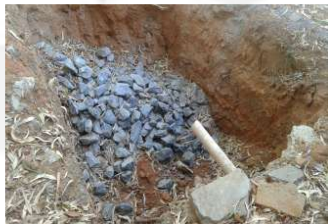
Foto 16. Sumidouro da Caixa Separadora Água-Óleo. (20/07/2015).
