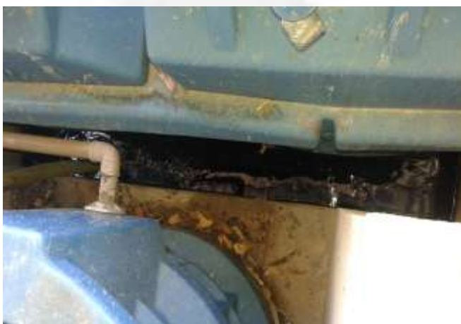
Foto 15. Caixa Separadora Água-Óleo com grande quantidade de óleo derramado em seu entorno (20/07/2015).
