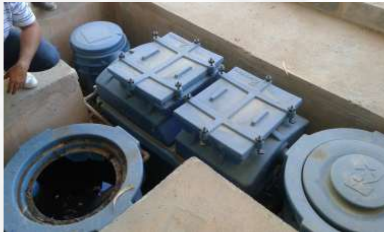
Foto 14. Vista da nova Caixa Separadora Água-Óleo (20/07/2015).
