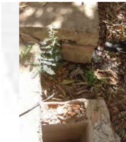
Foto 11. Caixa séptica do vestiário transbordando pela trinca próxima a tampa (20/07/2015).
