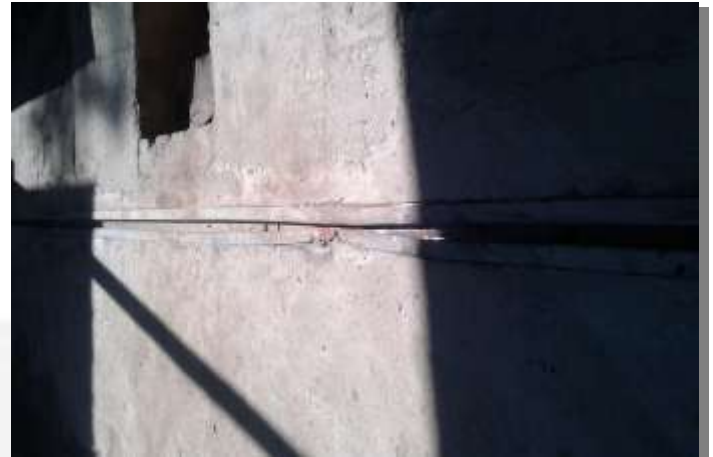
Foto 3. Canaleta obstruída na oficina de veículos e máquinas (20/07/2015).
